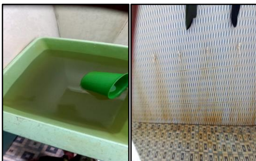
Gambar 1. Kondisi air dan kamar mandi kotor
